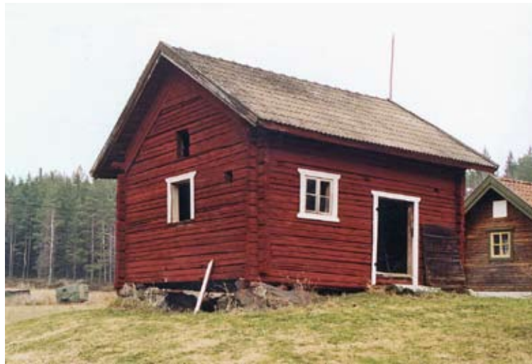
Visthusboden i Lindberga före renovering. Taket var i behov av omläggning och syllarna på två sidor behövde bytas ut.
